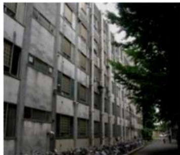
■外壁の落下の危険
