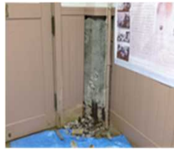
■長年の塩害等で爆裂した柱脚部
