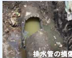
排水管の損傷
