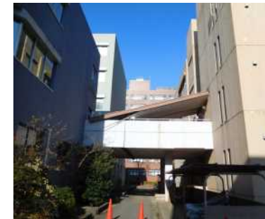
■連絡通路の屋根崩落
