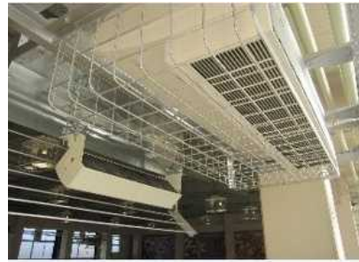
◆ 体育館に設置された空調設備
