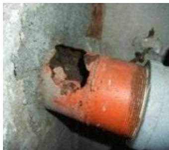
劣化による配管破損
