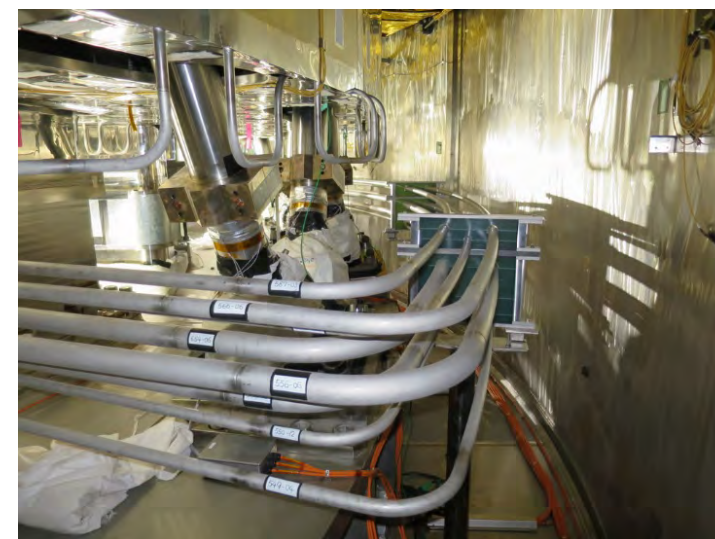
熱遮蔽体用冷媒配管
