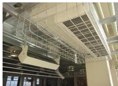
◆体育館に設置された空調設備
