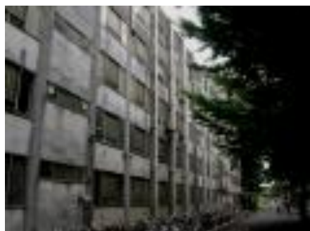
外壁の 落下の危険
