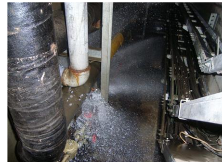
配管の破損による 水漏れ
