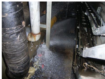
配管の破損による水漏れ
