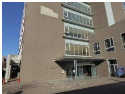
外壁の剥離、落下
