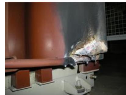
変圧器の発火による損傷
