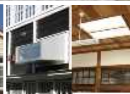
自然採光用光ダクト
