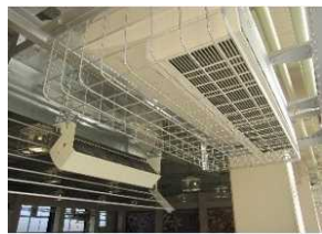
◆体育館に設置された空調設備
