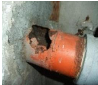
劣化による配管破損
