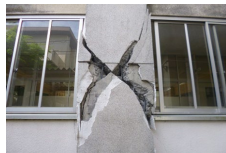
耐震化未完了の建物が 大規模地震で甚大な被害を受けた例
