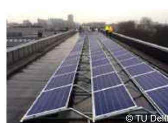
Pulse 屋上のソーラーパネル
