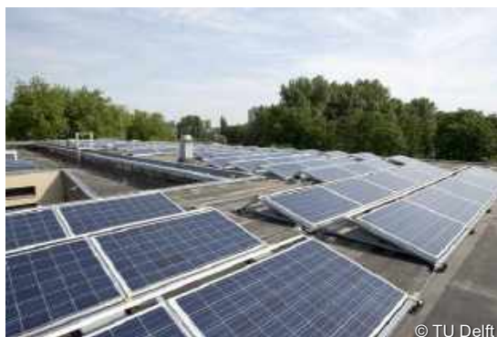
建物屋上に設置されたソーラーパネル
