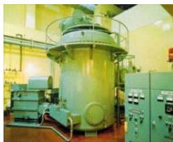
電子線照射設備
