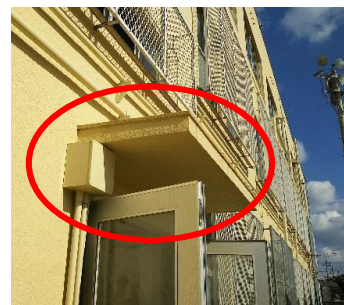
落下した庇と同形状の庇
