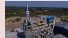
廃棄物発電設備 (ミャンマー・ヤンゴン)
