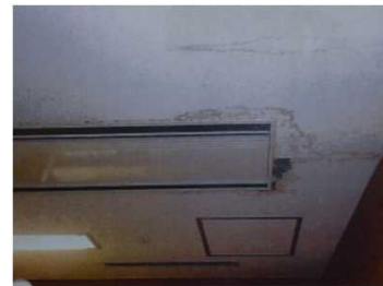
【空調設備（ファンコイル）】
