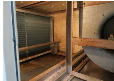
【空調設備（送風機）】
