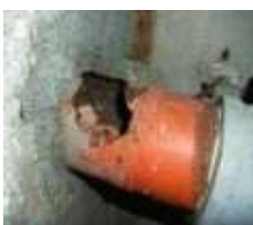
劣化による配管破損
