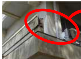
老朽化により手すりが落下
