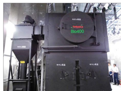
木質チップボイラー
