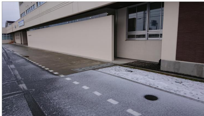
地下水の熱で融雪している様子
