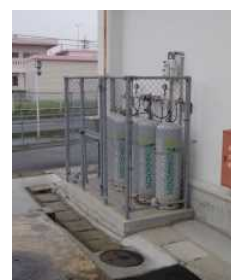
LPガスのタンク
