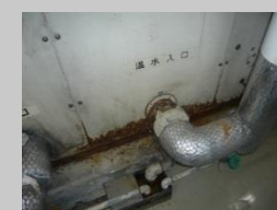
空調機から漏水
