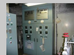
旧式自動制御盤
