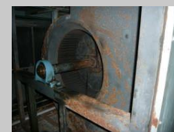
空調機内部劣化
