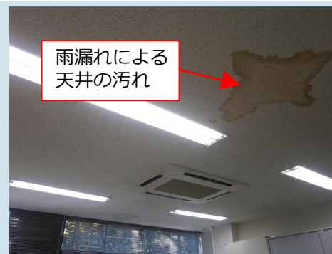
雨漏れによる天井の汚れ
