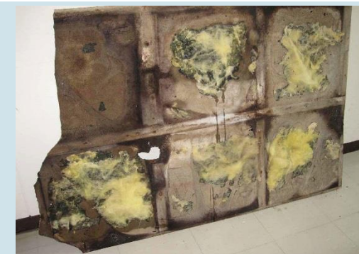
落下した天井材
