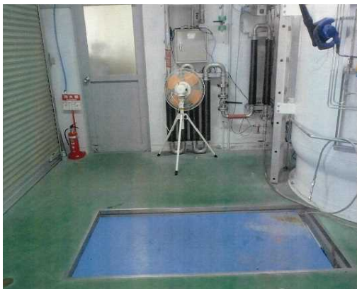
テーブルリフト装置 (床面青色) が浸水し、モーターが故障
