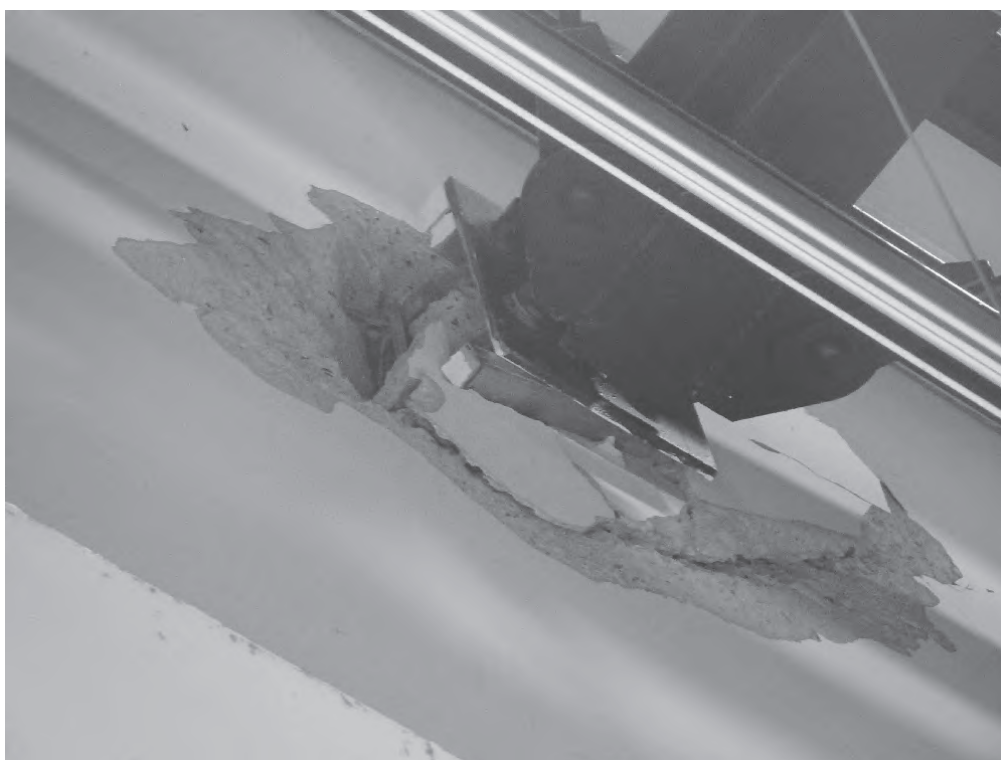
(b) コンクリートの破壊
