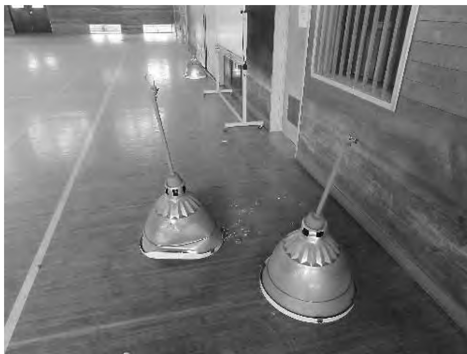
写真 4.14 落下した照明設備
