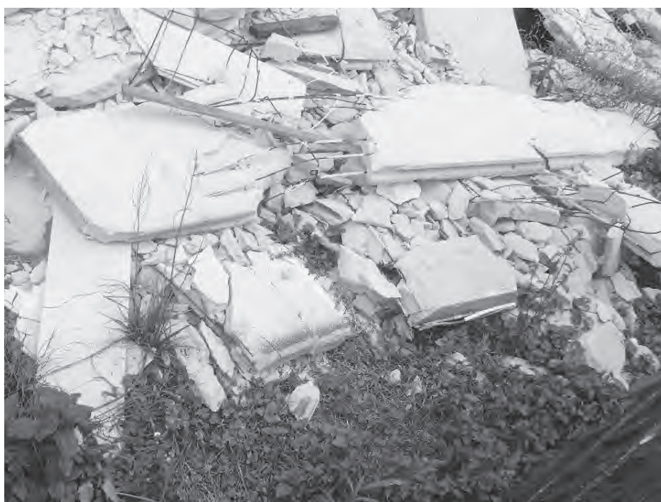
(b) 脱落した ALC パネル
