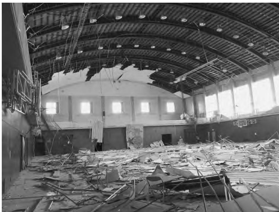
写真 4.9 耐震化されていない天井の崩落
