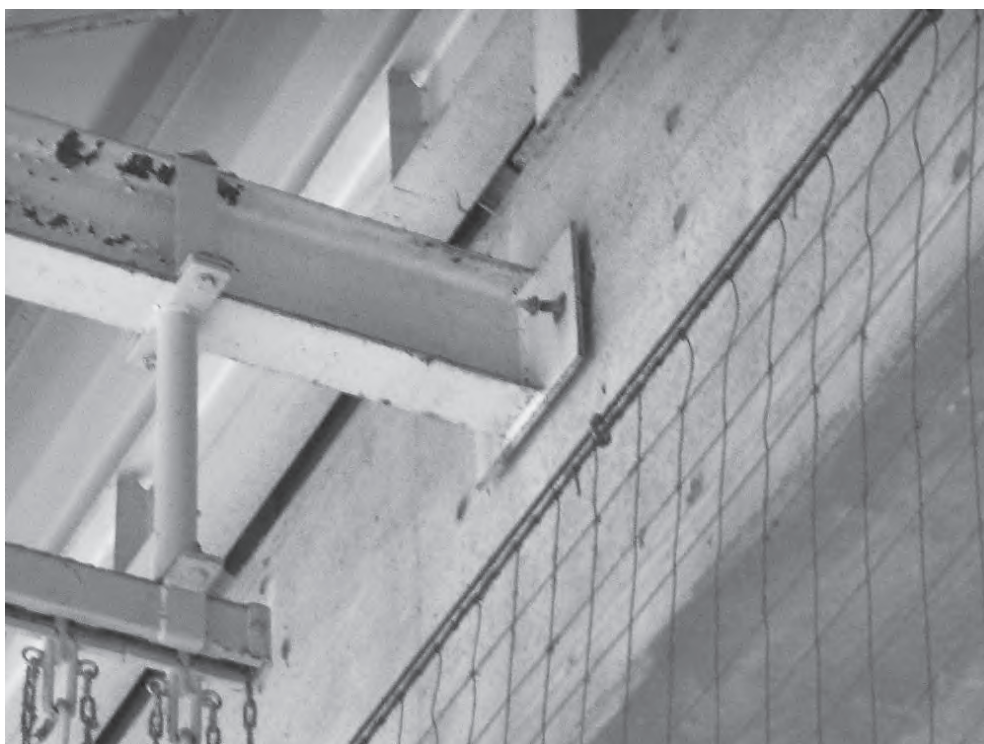
(a) あと施工アンカーの抜けだし
