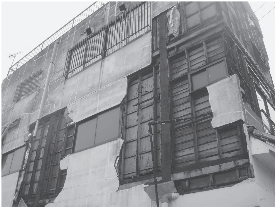
(a) ラスシート外壁の脱落
