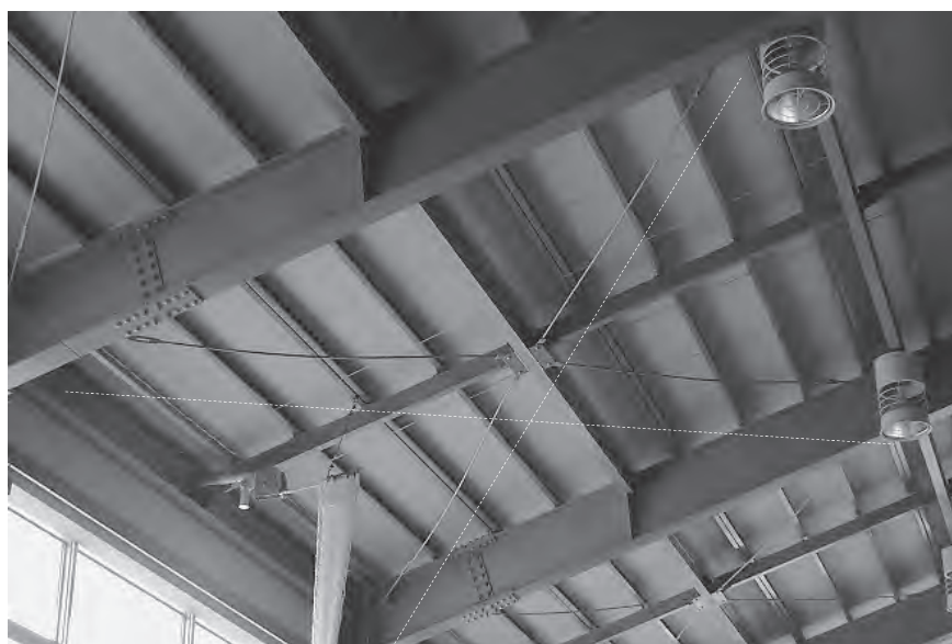
写真 4.8 たわみの見られる筋かいの例
