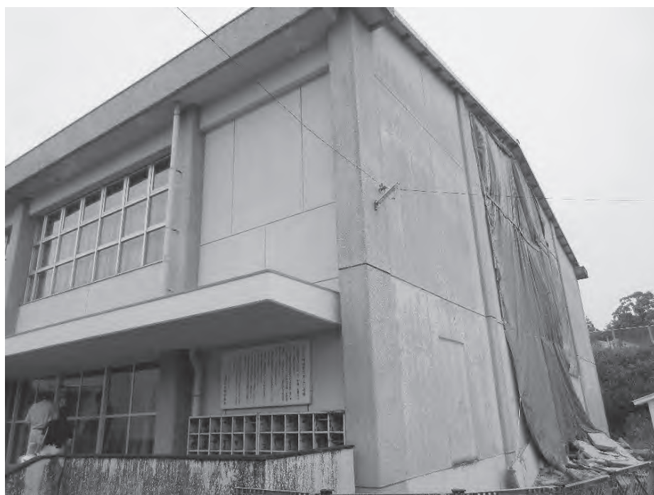
(a) 外壁が脱落した体育館の妻面
