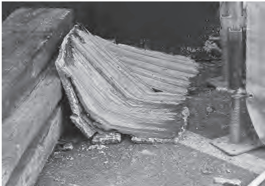
(b) 脱落したラスシート
