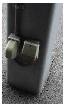
図6: 電気自動車充電装置
