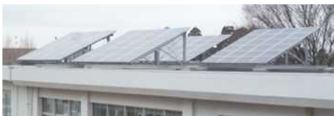
図4: 屋上の太陽光発電設備(20kW)
