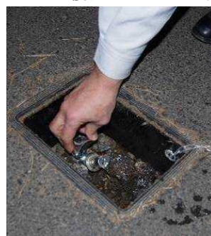
図4: 床に埋設された散水栓
