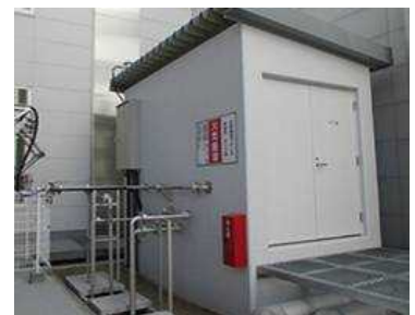
図4: 地上の給油ポンプ室
