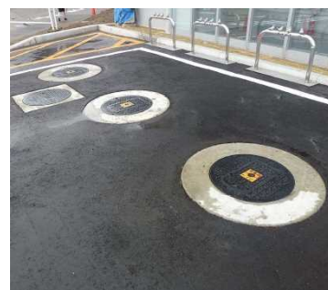
図6: マンホールトイレ
