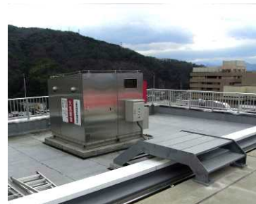
図5: ヘリポート横の給油設備
