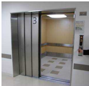
図4: 大型搬送エレベーター
