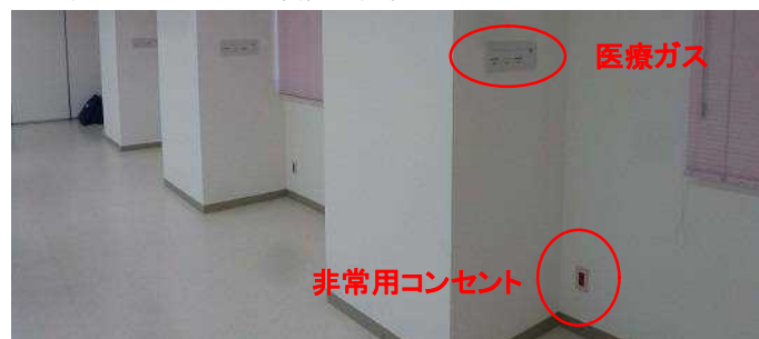
図5: 多目的研修室に設置された医療ガスと非常用コンセント
