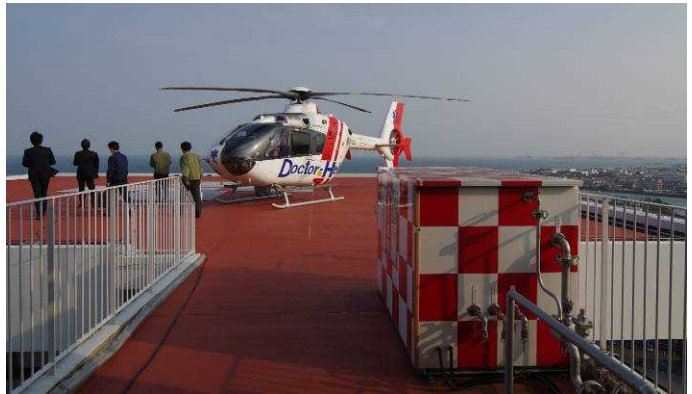
図2: ヘリポートと、新設した屋上給油ユニット(写真手前)
