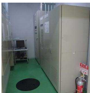
図5: 太陽光発電用蓄電池
