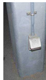
図5: 電源コンセント
