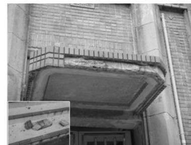
▲外壁タイルの剥落
