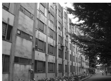
▲老朽施設の外観（経年48年）
