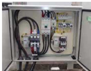
④ 発電機の取付口 (江戸川区提供)
