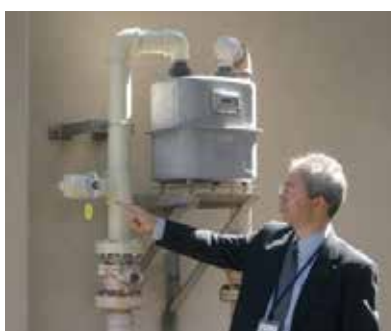
⑤LP ガスから都市ガスへの変換器の接続口
