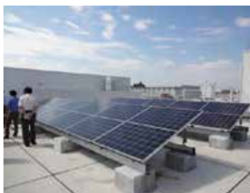
⑤ 自立運転可能な太陽光発電設備
