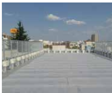
屋上に設置した柵（名古屋市） （名古屋市教育委員会提供）
