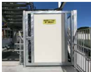
緊急時には蹴破って進入可能なドア
