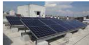
⑤自立運転可能な太陽光発電設備
