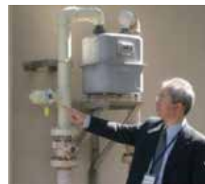
⑥ガス変換器の接続口
