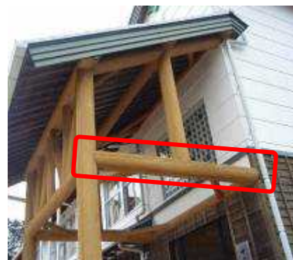
図2 腐食交換した横架材
