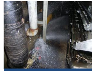
配管の破損による水漏れ
