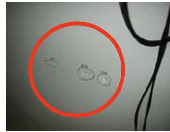
▲機器の衝突による壁の破損
