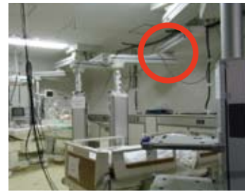
▲シーリングペンダントのアームのブレーキが弱くなり、地震の揺れで回転
