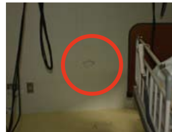
▲ベッド、キャスター機器の移動により壁が損傷
