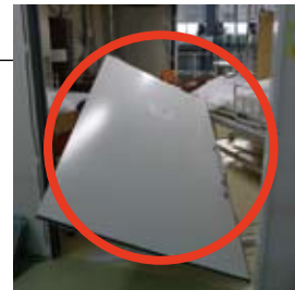
▶病室の扉が開閉・脱落
