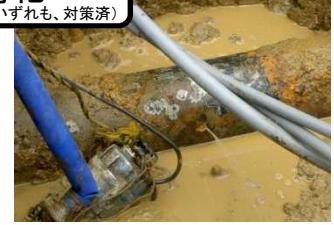
配管からの漏水
