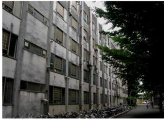
老朽施設の外観(築48年)(東工大)
