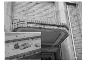
▲外壁タイルの剥落
