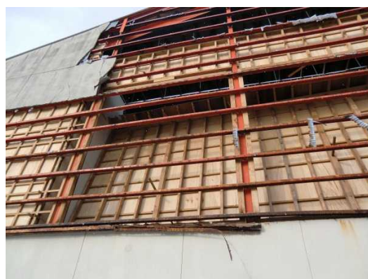
写真 33 取付け部の状態
