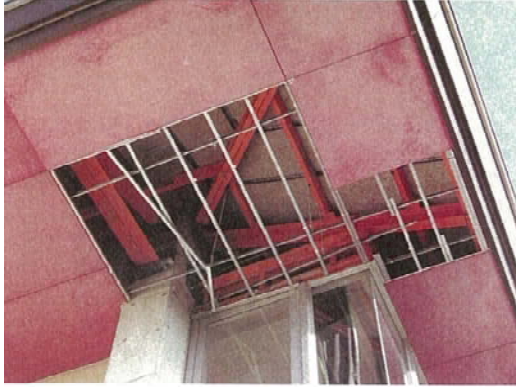
写真 43 軒天井の脱落
