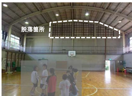
写真 38 妻面内壁（有孔ベニヤ板）の大規模脱落
