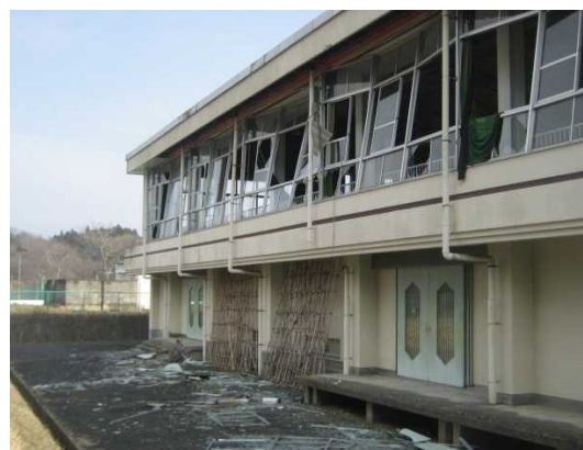
写真 32 横連窓の大規模な脱落・損傷（北面）
