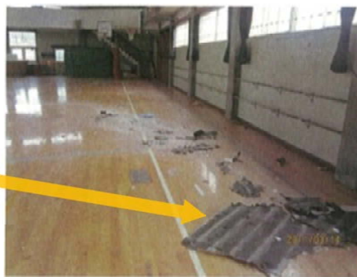
写真 42 脱落したモルタル
