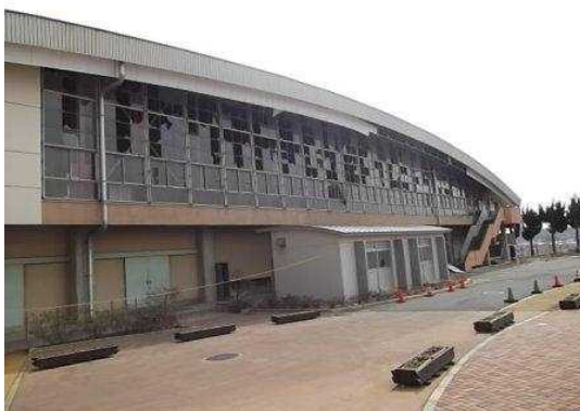
写真 29 桁行面の開口部の被害
