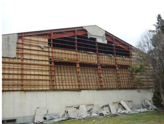
写真 32 外壁妻壁のラスシートの全面脱落
