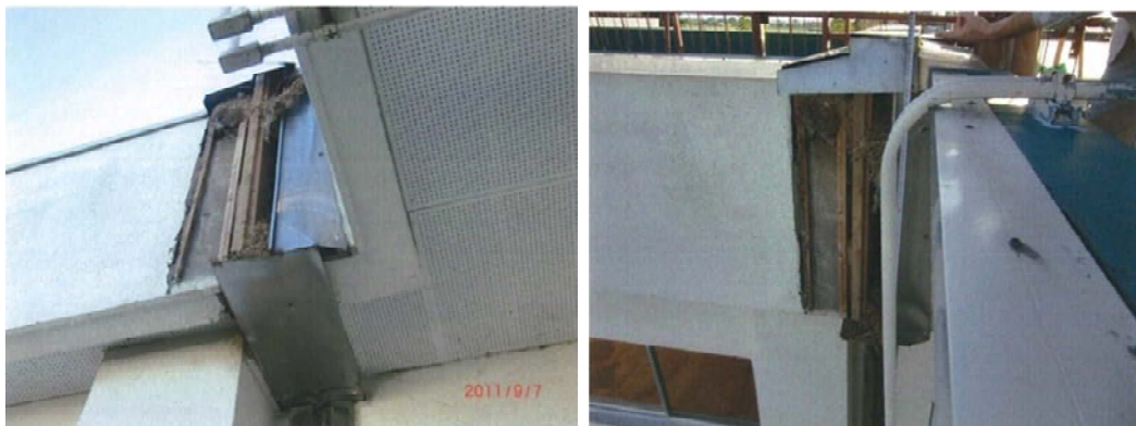
写真 26 エキスパンション・ジョイントカバーの脱落
