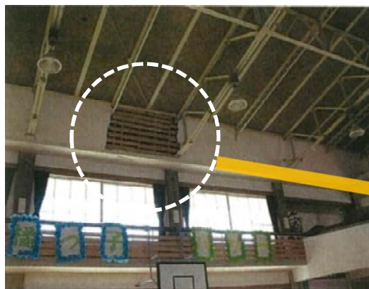
写真 41 内壁モルタルの脱落
