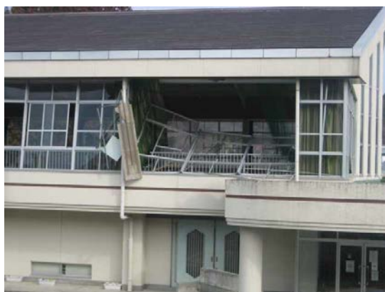
写真 31 横連窓の大規模な脱落・損傷（南面）
