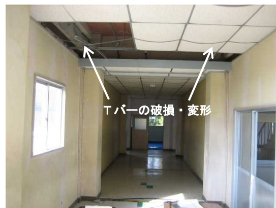
写真 13 T バーの破損・変形（廊下）
