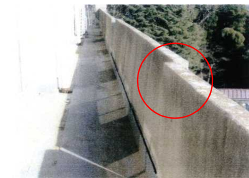
写真 21 バルコニー先端の RC 造腰壁の傾斜
