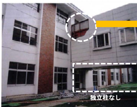
写真 17 外装材（押出成形セメント板）の脱落
