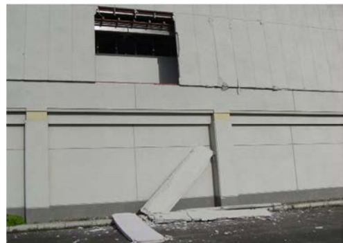
(参考) 写真 20 過去の震災における脱落被害
