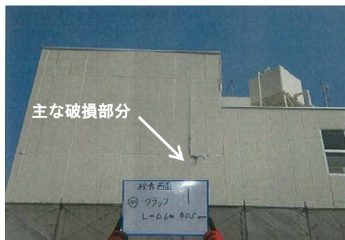
写真 19 外装材（ALC パネル）の損傷
