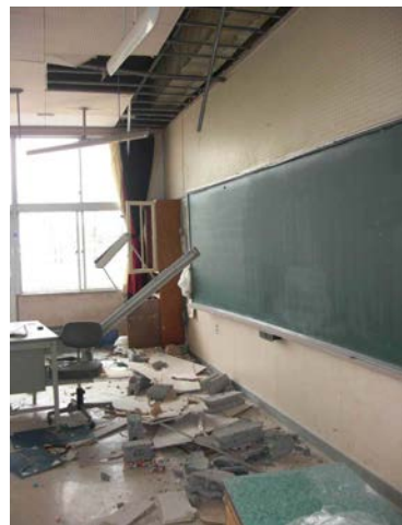
(参考) 写真 25 教室間のブロック壁が天井裏から落下した事例
