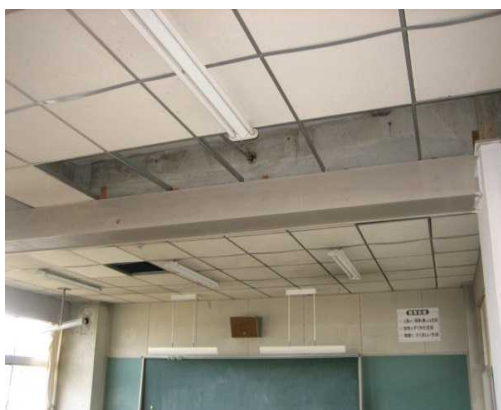
写真 12 システム天井の脱落（普通教室）
