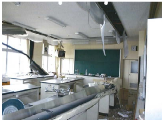
写真 14 天井裏の暖房設備の脱落
