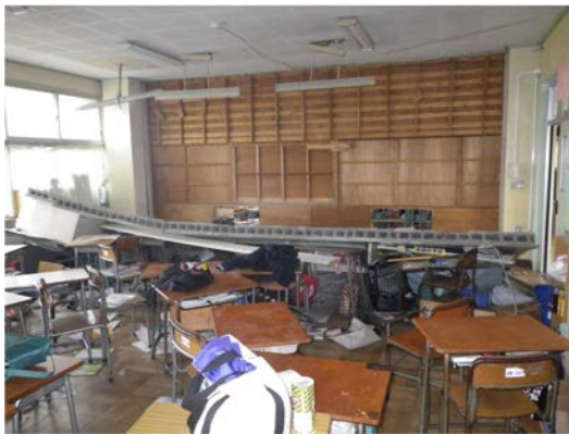
写真 22 コンクリートブロック壁の全面倒壊
