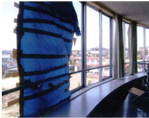
写真 15 横連窓の障子ごとの脱落（4 階音楽室）
