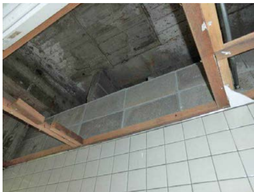
(参考) 写真 24 頂部にアンカーがなく ブロック壁が落下した事例
