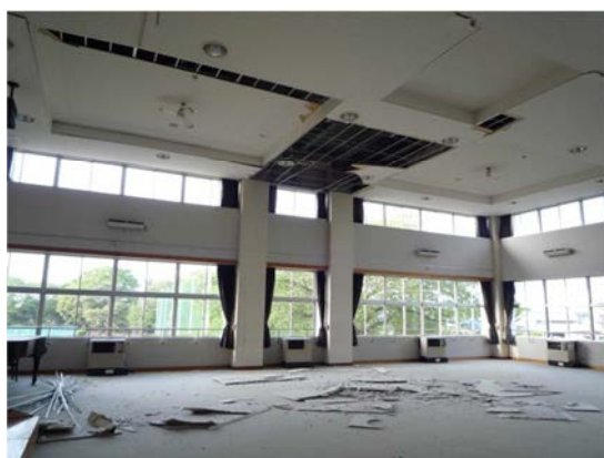
写真 10 階高の高い大空間の天井の脱落
