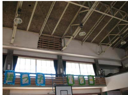
写真 9 内壁（ラスモルタル）の脱落
