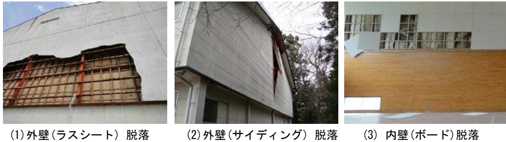
写真4 外壁・内壁の脱落
