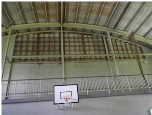
写真 8 内壁（有孔ベニヤ板）の脱落
