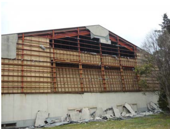
写真 7 外壁妻壁のラスシートの全面脱落
