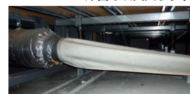
屋内運動場床下のダクト（ソックスダクト：布部分から均一に空気が吹き出す）
