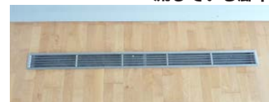
床面の吹出スリット
