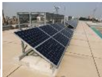
太陽光パネル
