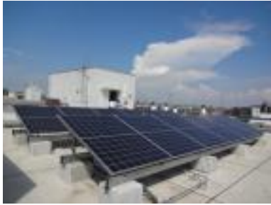
太陽光パネル
