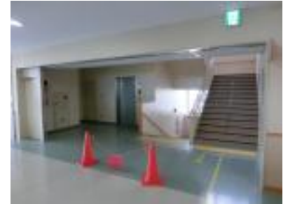
防火シャッター
