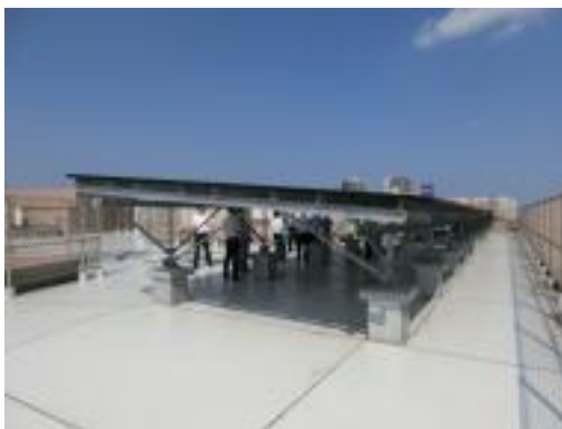
太陽光パネル
