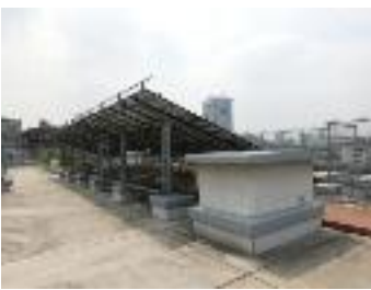
太陽光パネル
