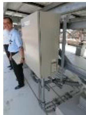
非常用電源プラグ
