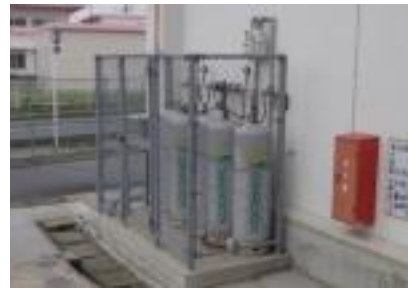
LPガスのタンク
