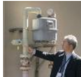
⑤ガス変換器の接続口
