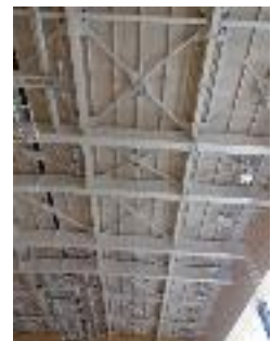
省エネのために設置した 屋内運動場の LED 照明 (東京都北区立十条富士見中学校)
