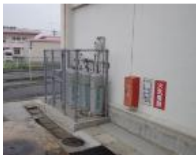
震災時にも炊き出しに利用した LPガスのタンク（宮城県立石巻支援学校）
