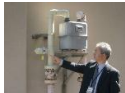
都市ガスエリアにおいても災害時には LPガスを使えるよう、LPガス変換器の 接続口を整備（新潟県長岡市） (長岡市教育委員会提供)
