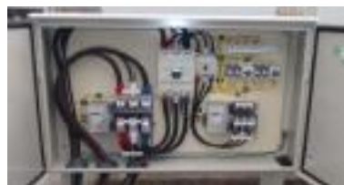
④発電機の取付口 (江戸川区提供)
