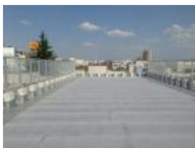
屋上に設置した柵(名古屋市) (名古屋市教育委員会提供)
