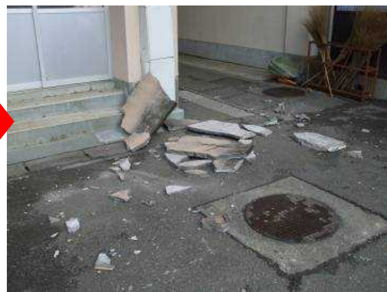
モルタル片が落下(築31年)
