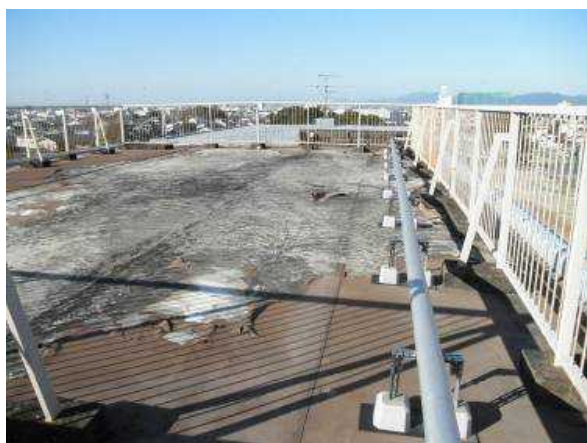
防水層の劣化。内部では雨漏りが発生し、 廊下の天井、床面を汚損（築37年）
