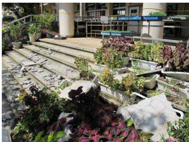
外壁のモルタルが剥落 児童が軽傷(築29年)
