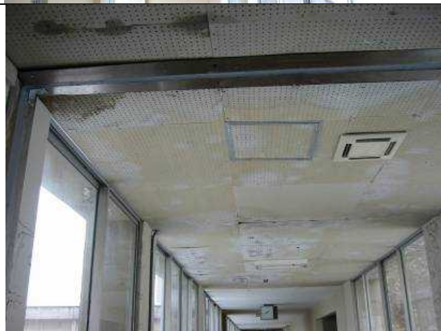
雨漏りにより天井が劣化(築31年)
