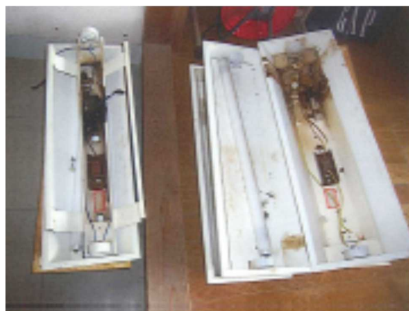
照明安定器が破裂(築41年)
