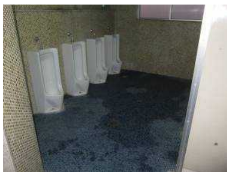
トイレの老朽化による臭気
