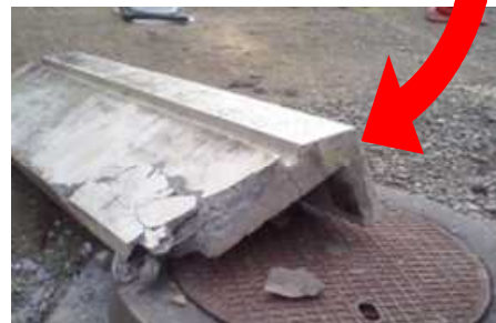
老朽化による手すりの落下
