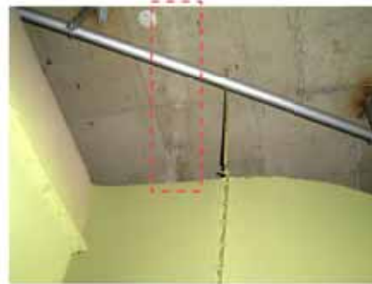
⑥ひび割れ (w=0.25mm)
