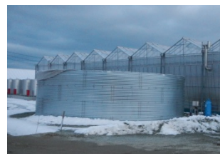
雨水利用システムのタンク
