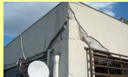
外壁が剥がれ落ちた校舎
