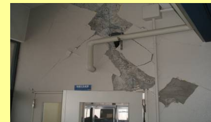
地震により亀裂が入り、剥がれ落ちた壁
