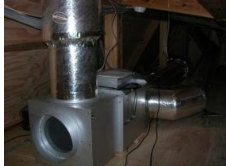
吸排気ダクト
