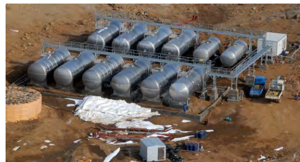
金属燃料タンクと防油堤
