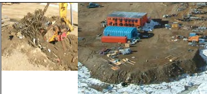
埋め立て廃棄物の調査 36m×27m×4mの大きさを推定、試掘および土壌分析を実施した。今後は、処理方法を検討する。
