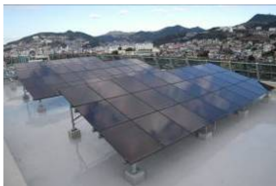
屋上に設置した太陽光発電用パネル
