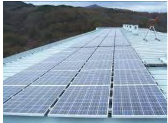
校舎屋根に設置したソーラーパネル
